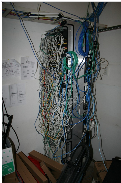
Una torre de servidores montada en un garaje. Muchas de las webs que visitamos en la red no dependen de grandes multinacionales de las telecomunicaciones o grandes instituciones universitarias. Luchar por una infraestructura de telecomunicaciones independiente, gestionada por los propios ciudadanos en una de las labores de muchos hacktivistas. [Foto de Skippy13 con licencia CC-by-sa, tomada de Flickr.com]
